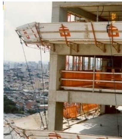
Plataformas de Proteção
